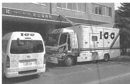
病院の年次点検時に電源供給
